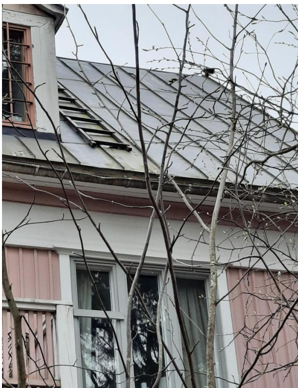
Kuva 3. Painuma talon räystäässä.
